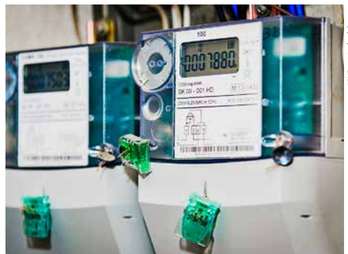
Künftig sind Massendaten aus perspektivisch Millionen von intelligenten Messsystemen (iMSys) zu verarbeiten.
